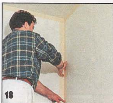
18 Такой же лентой оклеивают все внутренние углы, в том числе углы между стенами и потолком.
